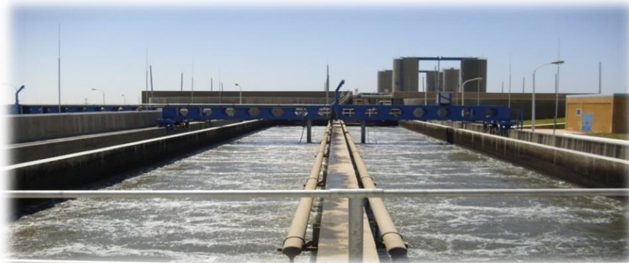
Figure 11 : Dispositif de dessablage et de déshuilage.
